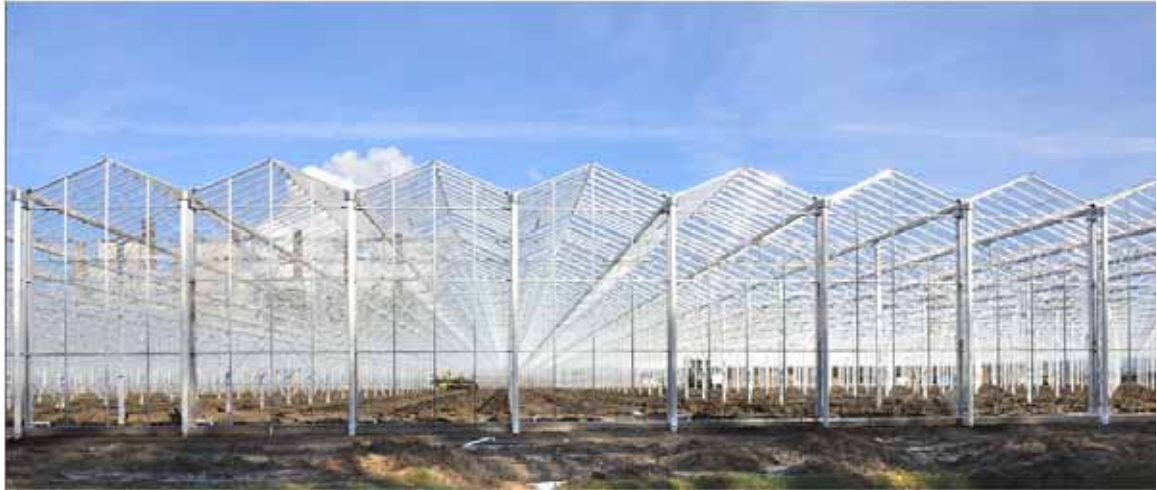
Bild 2.2: Die Konstruktion des Gewächshauses. Im Hintergrund links das Kraftwerk Neurath, von wo aus das Gewächshaus beheizt wird.
